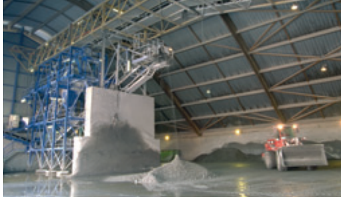
Zone de stockage des mâchefers
